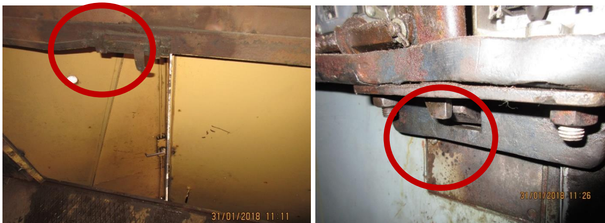
33. att Šahtas durvju slēgmehānismu neatbilstošs stāvoklis (šahtas durvis iespējams atvērt ja pretī neatrodas lifta kabīne)
