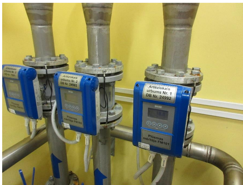
29. att. Ūdens ieguves vietā uzstādītie plūsmas mērītāji
